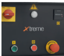
Commande électrique basse tension (24V AC) avec démarrage étoile / triangle
